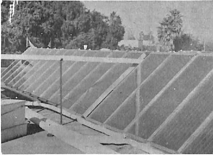
Colectores solares en Hotel Diego de Almeyda de Copiapó.
